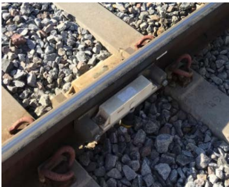
BILD 1, Axelräknarsystemets avläsningshuvud (motsvarar Isol, finns vid gränsen mellan två axelräknarsträckor)
