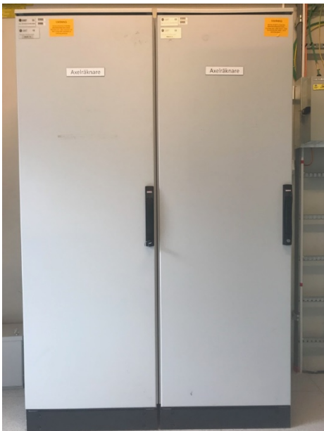
BILD 4 , skåp i signalteknikutrymme
